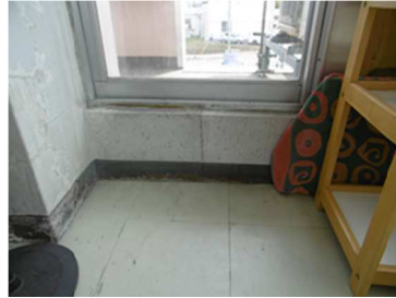
窓廻りの老朽化と 窓下のひび割れ
