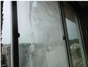
割れている窓
