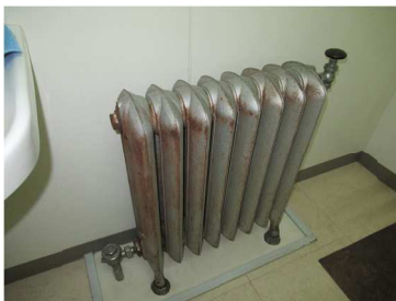
旧式の暖房設備
