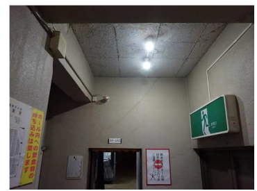
内壁ひび割れ
