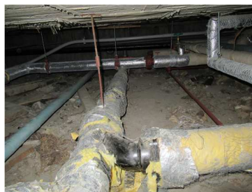
設備配管劣化状況
